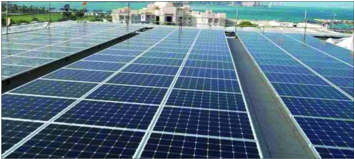
카르사아 발전소 The Kharsaa Plant
